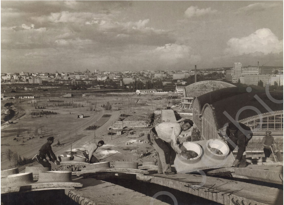
Слика 11: Монтажа кровних прозора Хале 1. Аутор непознат, око 1956. године. Извор: фото документација КМГ Трудбеник, Музеј науке и технике, Београд.
